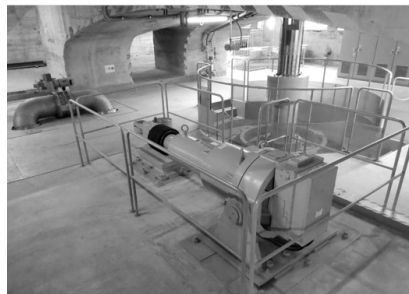
Fig. 4 生保内発電所の立軸フランシス水車
