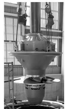
Fig. 5 風見発電所の立軸カプラン水車
