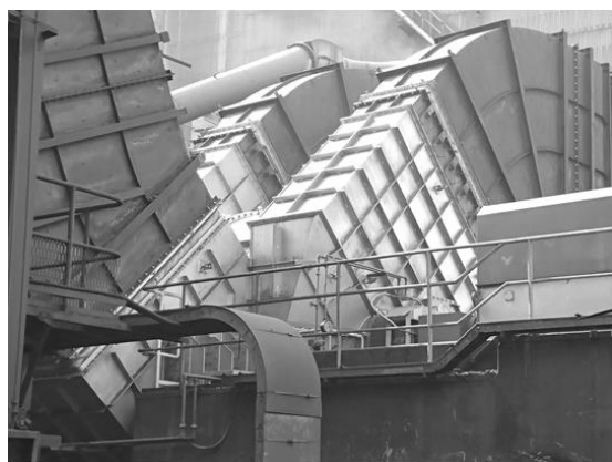
Fig. 7 高炉鑄床集塵機用送風機1,650 kW (日本機械技術)
