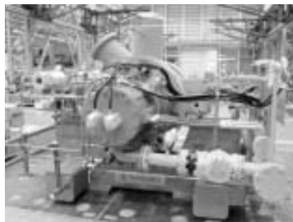
Fig. 4 バレル型高圧ボイラ給水ポンプ (西島)
