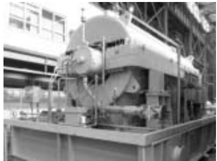
Fig. 7 中国向け石油化学コンプレッサ(荏原エリオット)
