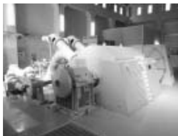
図13 横軸二輪四射ペルトン水車 (和合発電所)
