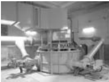
図9 立軸四射ペルトン水車 (大町新堰発電所)
