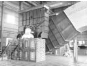
図 21 大手化学会社向け2,500 kWボイラー用 IDF(日本機械技研)
