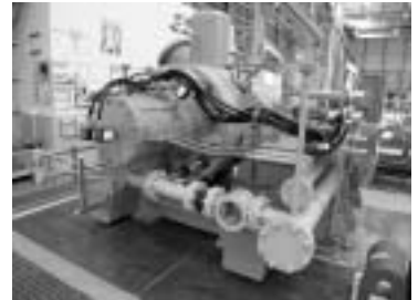
図6 パレル型ボイラ給水ポンプ(西島)
